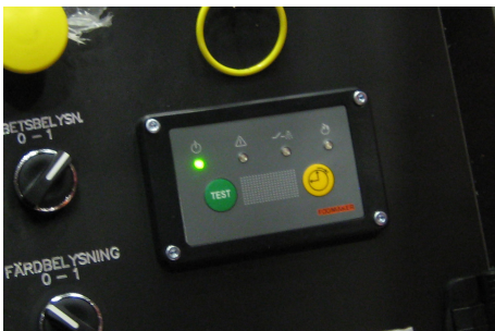
Figur 69. Larmpanel installerad i instrumentpanelen.
